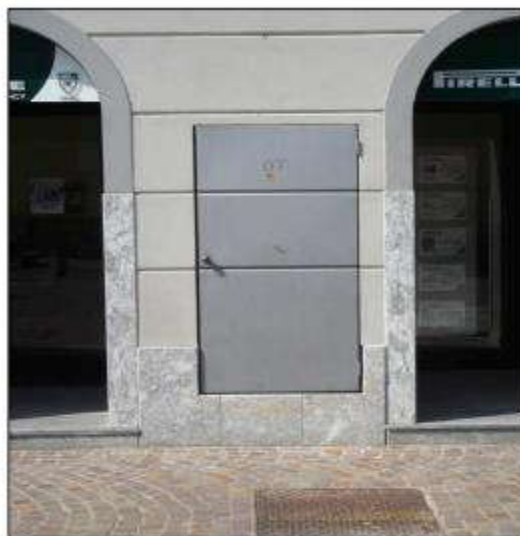
Esempio di impianto tecnologico in nicchia con materiale e disegno armonizzato con la facciata
